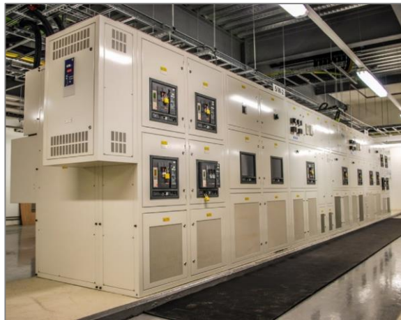
機電與緊急電源設施
