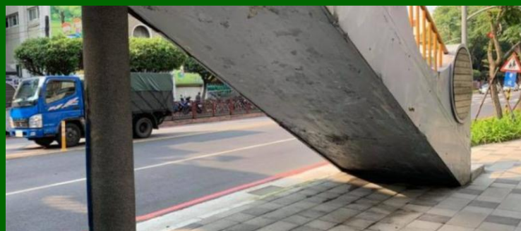
天橋樓梯下方無遮擋設計，很容易讓視障者撞到頭。
